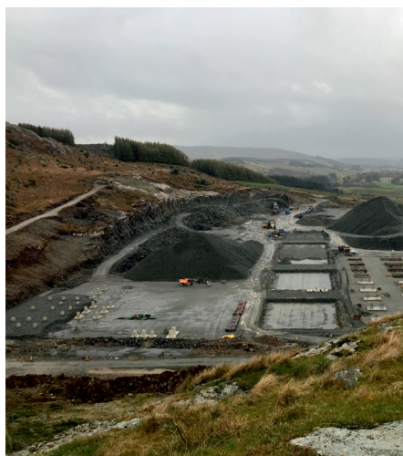
Fagrafjell transformatorstasjon Kvernaland
